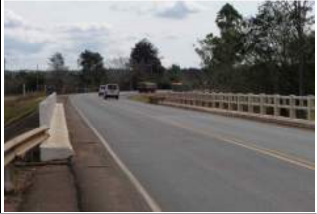
Prog. 84+000 Necesidad de Banquina
