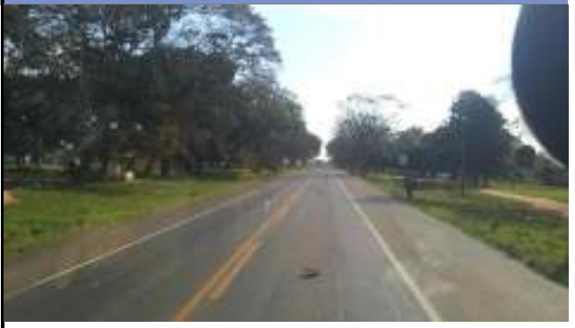
Prog. 172+000 Pavimentos Dañados
