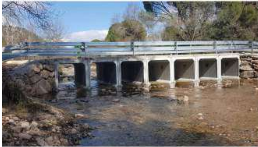
Figura 41: Detalle batería de marcos para desvío provisional de carretera sobre un río. Fuente: Elaboración propia.
