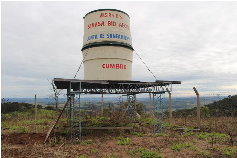
Tanque de fibrocemento instalado sin uso por falta de agua y vallado perimetral
