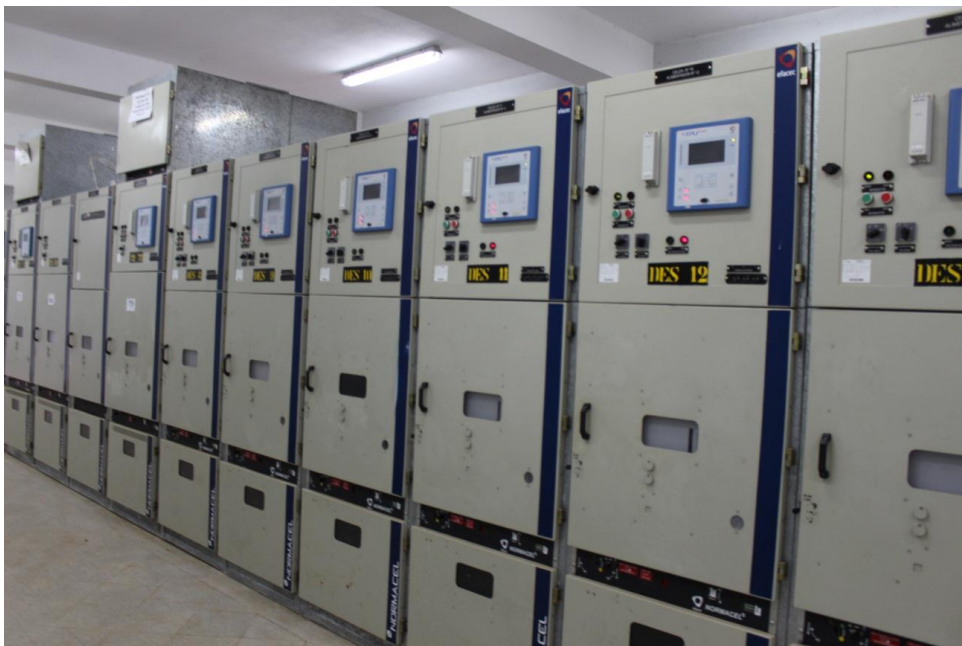
Sistemas de protección, medición y control en operación
