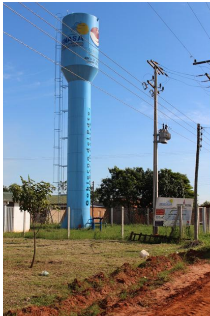
Pozo, tanque tipo copa instalado, extensión eléctrica, caseta de operaciones, vallado perimetral y cartel de visibilidad
