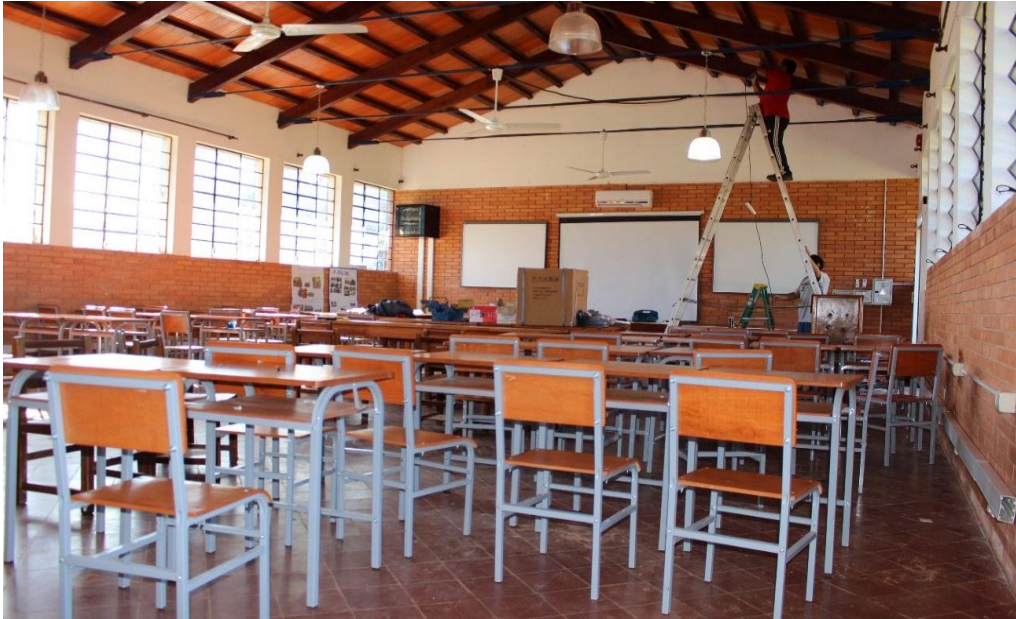
Trabajos de instalaciones eléctricas realizado por técnicos de DATA LAB en el laboratorio Informático.
