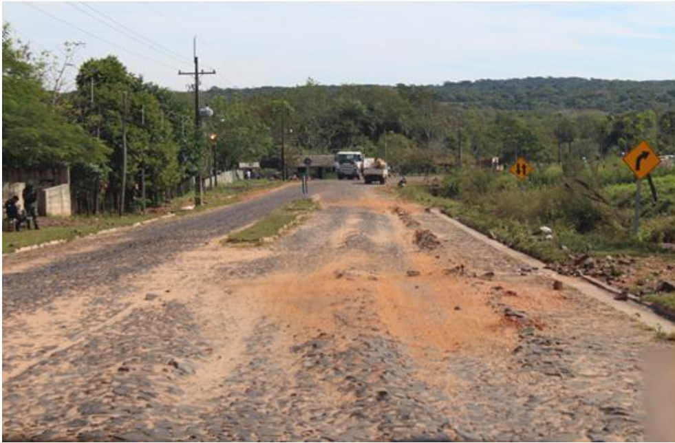
Hundimiento del empedrado en algunos tramos
