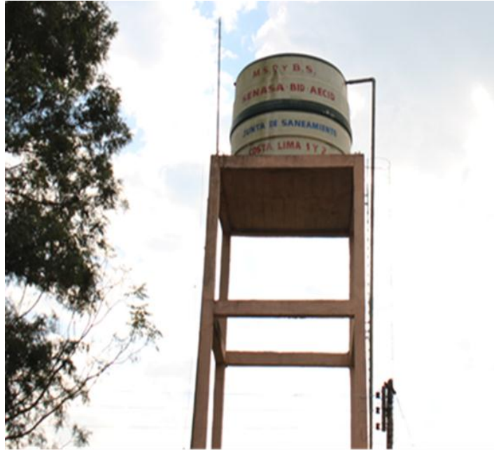
Tanque de fibrocemento elevado
