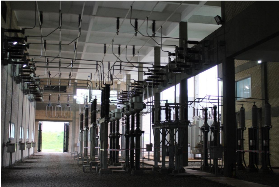
Equipamiento eléctrico instalado y en operación
